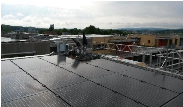
Abb. 1 PVT Kollektoren auf Teildächern von Gebäude B
