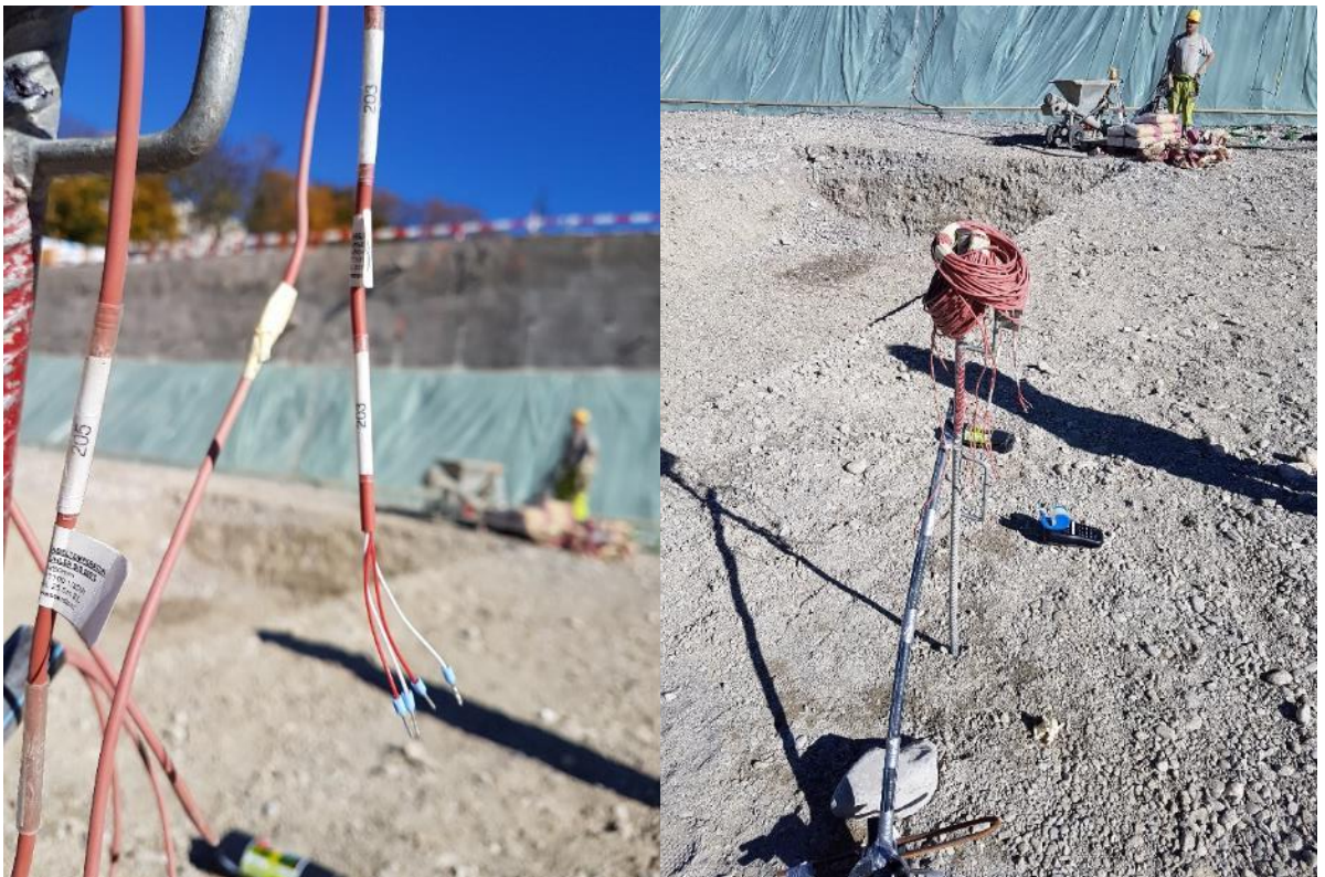
Abb. 2 Temperaturfühler unter der Bodenplatte
