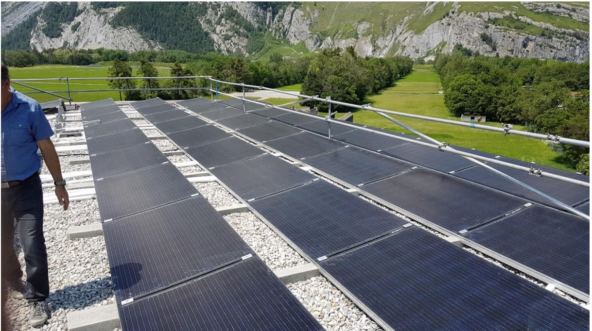
Abb. 9 Fertig installierte PVT-Module
