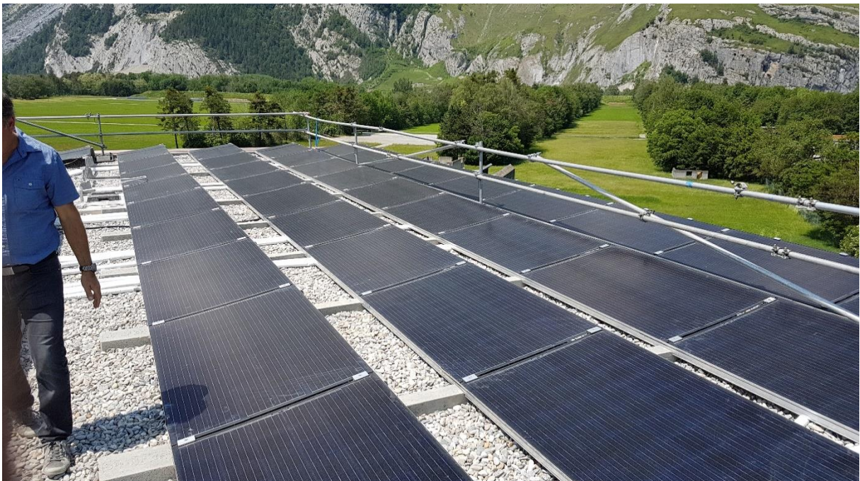
Abbildung 6: Fertig installierte PVT-Module.
