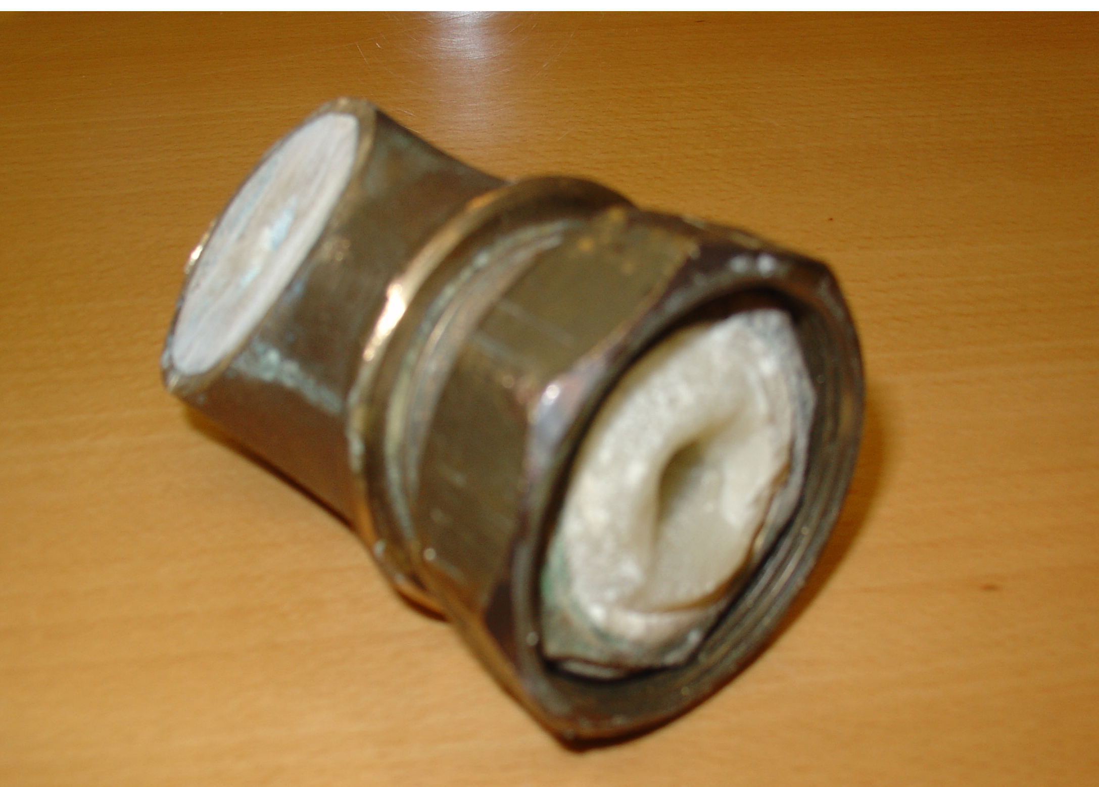
Abb. 1: Verkalktes Rohrstück nach 7 Jahren Nutzung
