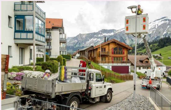
Abbildung 3: Strassenbeleuchtung Flühli (CKW / Philipp Schmidli)
