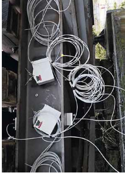
8 Sensoren und Verkabelung zur Messung der Dehnungen in den Stahlprofilen der Eisenbahnbrücke Wila (Projektarbeit Uwe Duk, 2017)
