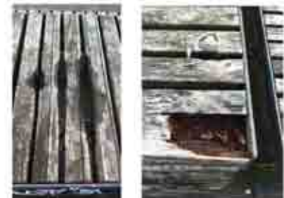
Brandlöcher und Vandalismus am Holzbalken Maria Girod (323889)
